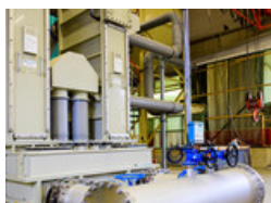
In den turmartigen „Coplatoren“ wird das Trinkwasser durch Anreicherung mit Sauerstoff entsäuert.
